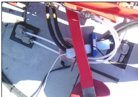
Fot. 3. Widok montażu cewki Rogowskiego i przetwornika LEM na pojeździe (fot. K. Ortel)
